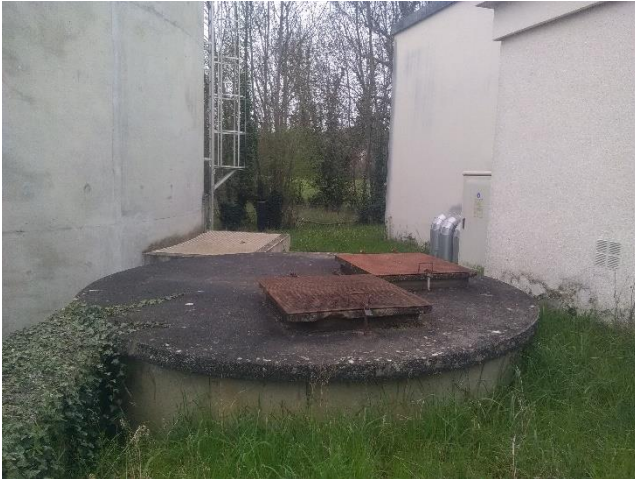
Tête du captage de Basse Terne
